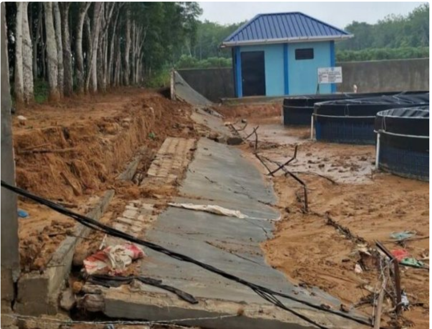
Pagar pembatas Balai Benih Ikan Air Tawar (BBIAT) di Desa Buko Poso Roboh
